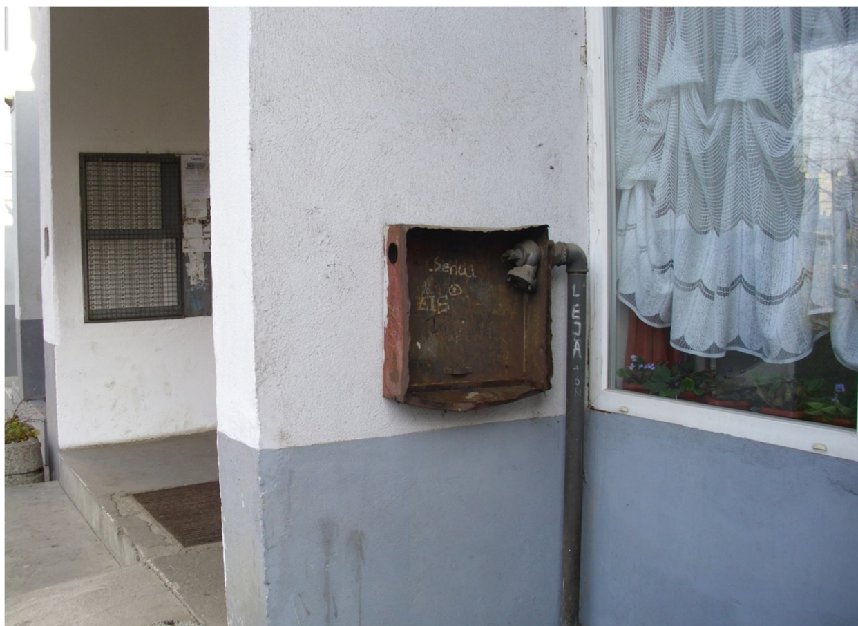
Slika 9. Nepristupačna i neispravna hidrantska mreža na pojedinim lokacijama
